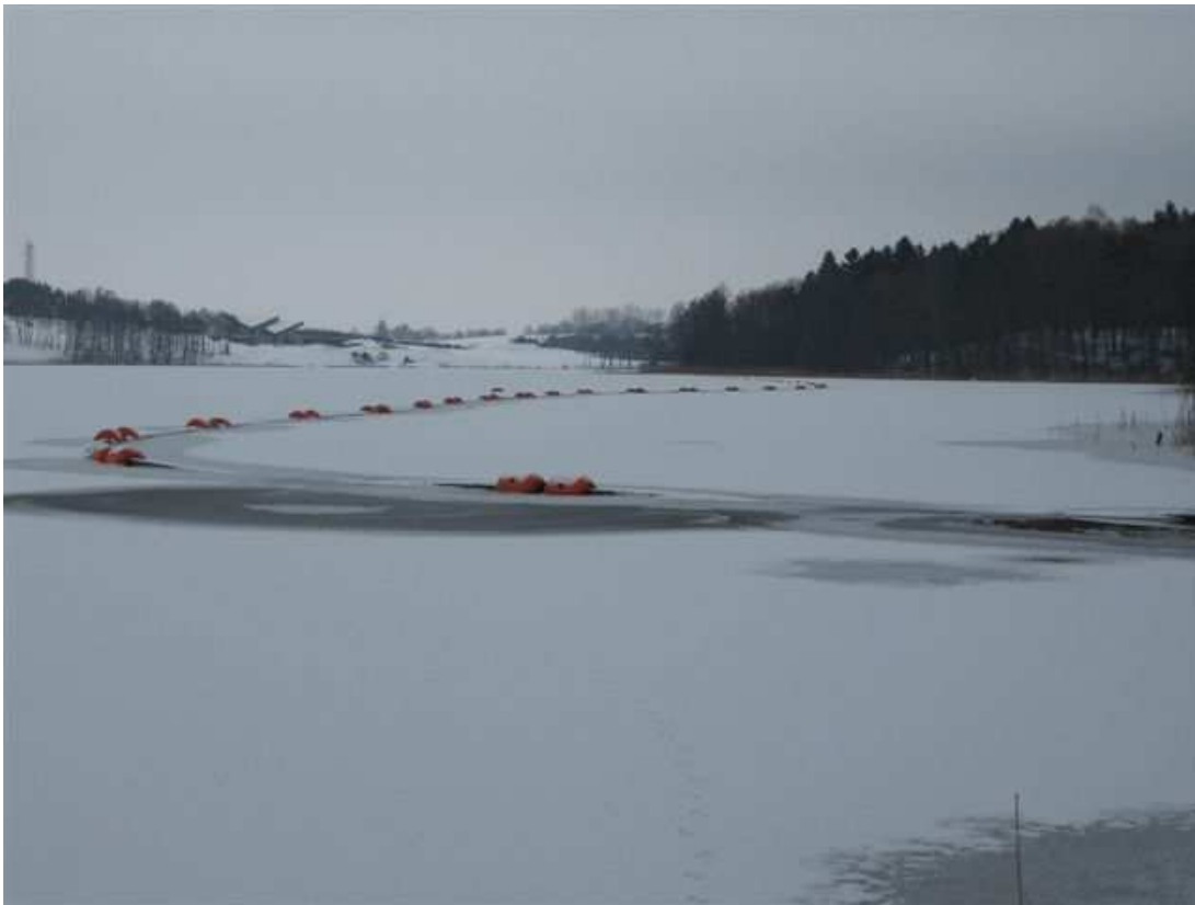
Fot. 4. Rurociąg ssąco – tłoczący na tzw. odcinku iławskim (jezioro Dauby).
