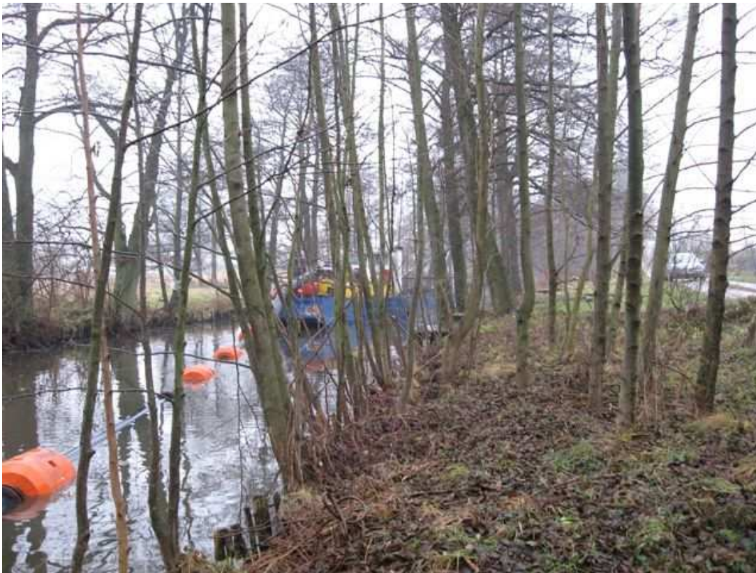
Fot. 2. Rurociąg ssąco – tłoczący na odcinku Miłomłyn – Itawa.
